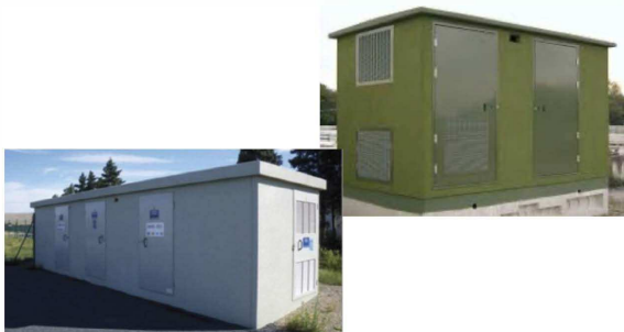
Poste de transformation
